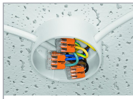
Distribution d'éclairage dans les plafonniers
